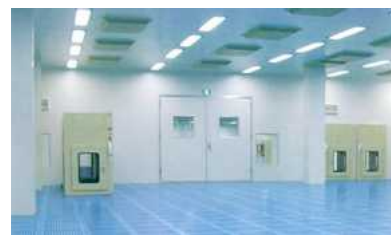
クリーンルーム
